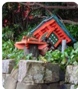
参道木製燈籠破損
