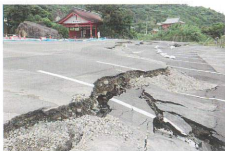
令和2年 7月6日豪雨被害
