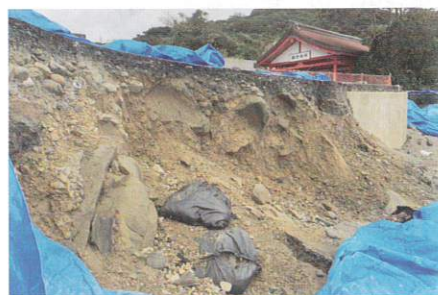
令和3年 9月16日豪雨被害
